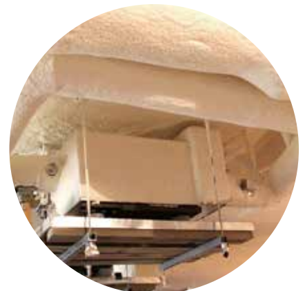
Canale pentru tubulaturi HVAC
