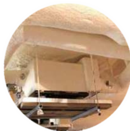
Canale pentru tubulaturi HVAC
